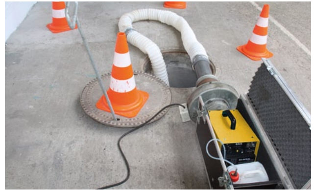
Gerätetechnik für Vernebelungsanlage
